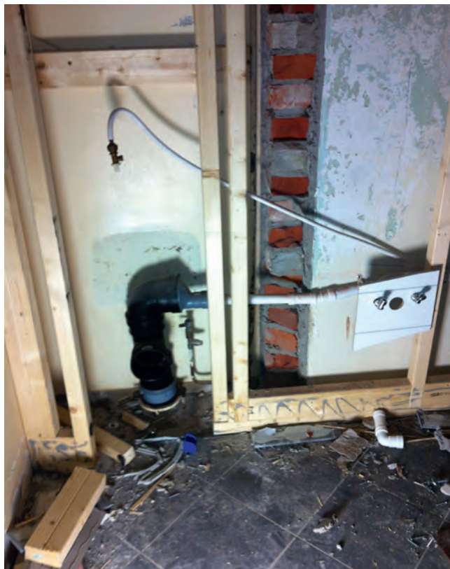
Under rivningen av badene ble det avdekket store feil og mangler. Tilstanden på rørene viste at det var på høy tid med oppgradering samt at flere bad var kosmetisk oppusset, men tålte ikke vann. Dette bekrefter viktigheten av skikkelig godt gjennomført rehabilitering.
