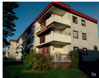
Frostspengning og korrosjon
