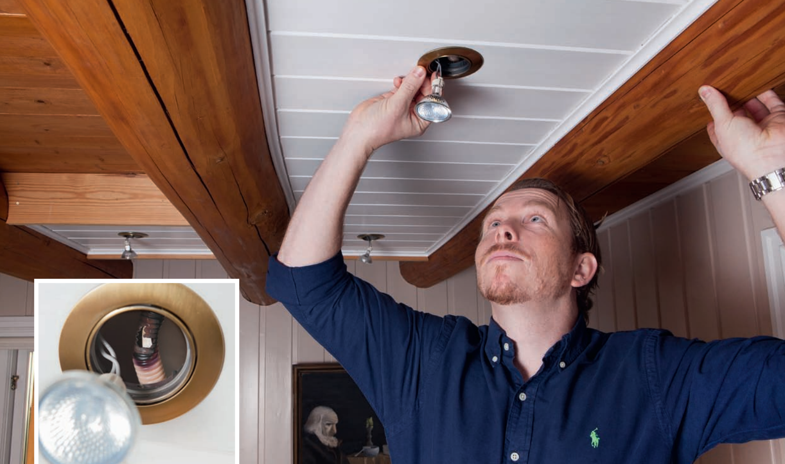
Skadesjef i Forsikring for medlemmer, Jan Petter Myhrstad, viser et eksempel på feilinstallasjon av downlights, hvor det er svidd hull i trekkerøret med strømledning.
